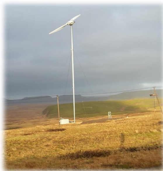
Рисунок 1 – Ветроустановка французской фирмы Vergnet Eolien установленные в с. Никольское
